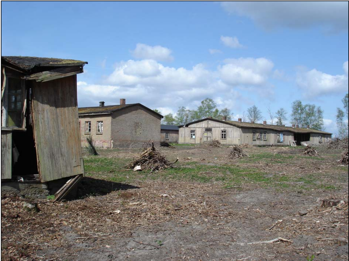
Blick auf die so genannte »CVJM-Baracke« (links), die Latrine (Mitte) und die Unterkunftsbaracken (rechts). Deutlich erkennbar ist der marode Zustand der Holzbaracken. Foto: Andreas Ehresmann, 18.04.2007.
